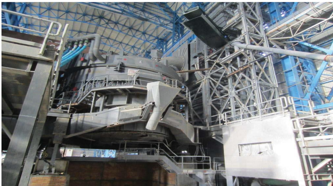
سیستم انتقال مواد داخل سالن فولاد سازی
