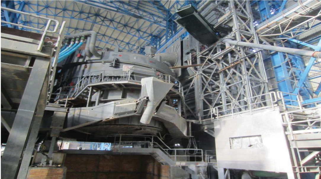
سیستم انتقال مواد داخل سالن فولاد سازی
